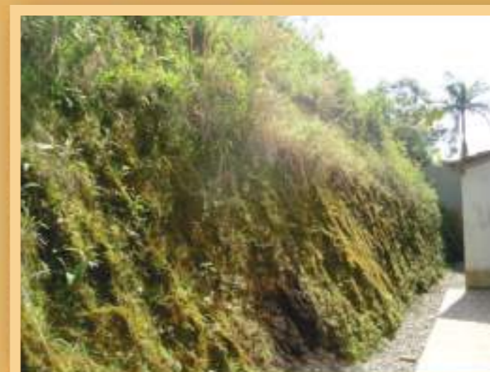
Talude de corte. Bairro Carvalho. Foto: Compdec
