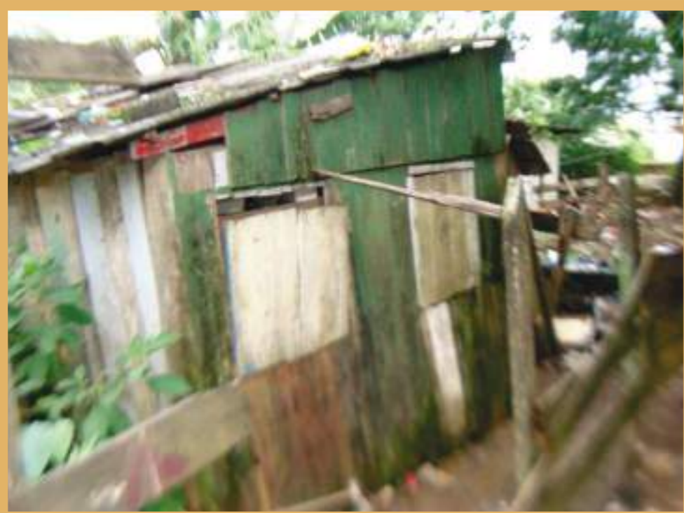
Figura 15 - Moradia em madeira. NSG. Foto: Compdec
