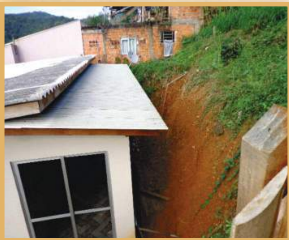
Figura 19 - Relação da moradia e talude. M. Crisântemos. Foto: Comdec
