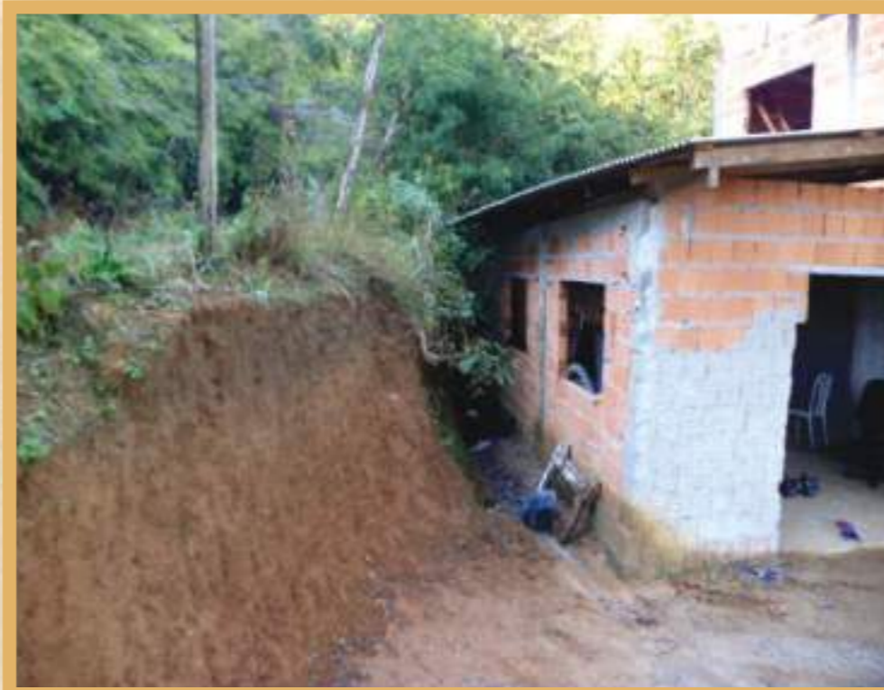
Figura 18 - Corte de talude/moradia em alvenaria. Padre Jacó. Foto: Compdec
