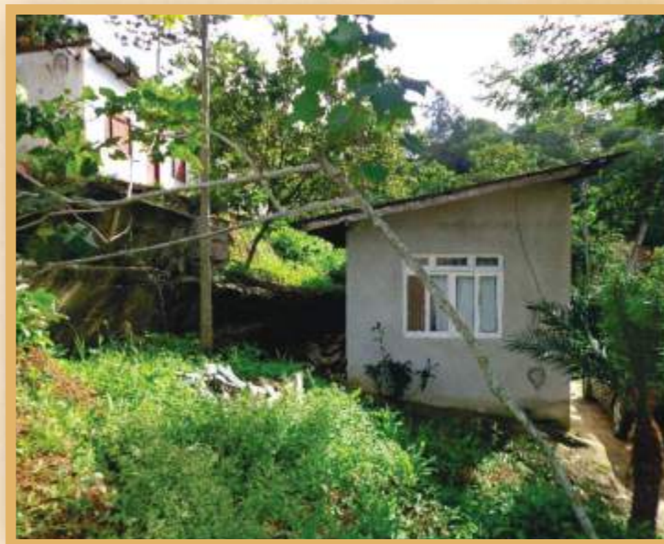
Figura 20 - Muro embarrigado. M. Aririba. Foto: Comdec
