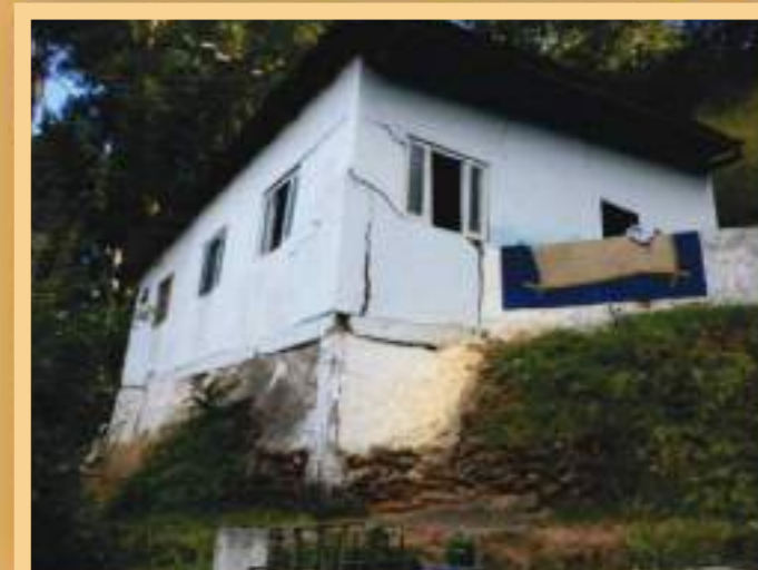
Residência avariada (rachaduras). Morro do Azeite. Foto: Compdec
