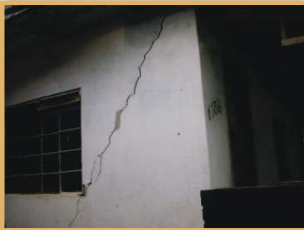
Figura 8 - Rachadura em parede, causada pela movimentação do solo. Bairro Limoeiro. Foto:Compdec
