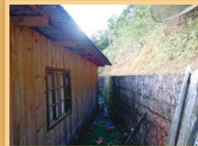
Muro de contenção. Rua Francisco Vechani. Foto: Compdec
